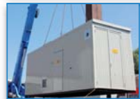
CONTAINERDAMPFANLAGE komplett ausgerüstet und betriebsbereit
